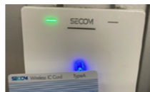
入退室管理システム (ICカードリーダー)
